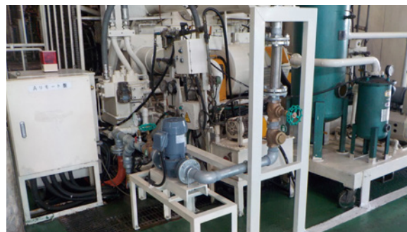
鑄造設備の冷却水循環装置
