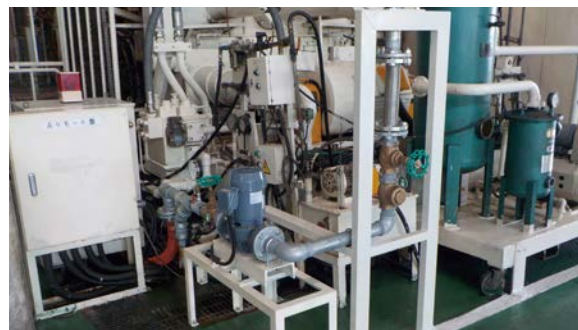
鑄造設備の冷却水循環装置
