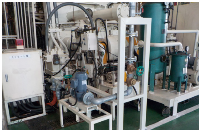
鋳造設備の冷却水循環装置
