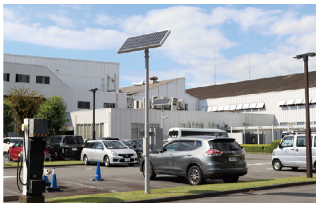
富士本社に設置中の太陽光発電外灯
