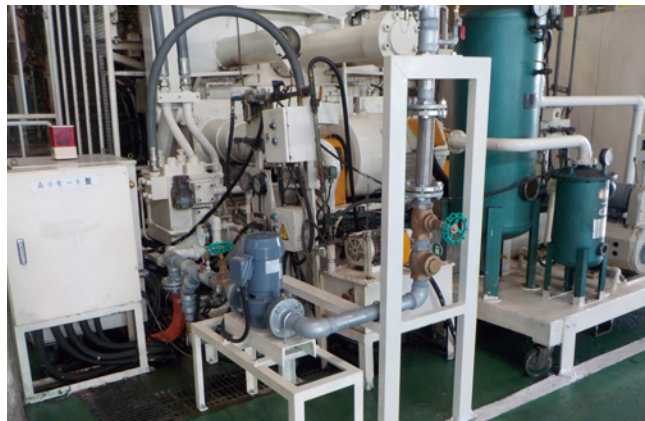
鋳造設備の冷却水循環装置
