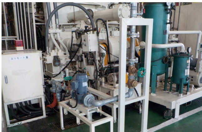
鋳造設備の冷却水循環装置
