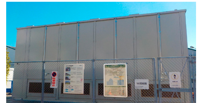
NaS電池設備
