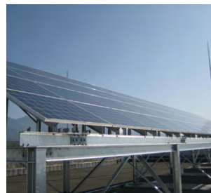
太陽光発電システム
