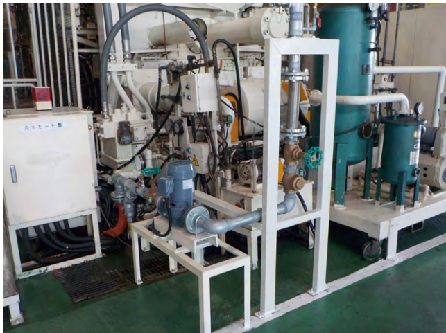
鋳造設備の冷却水循環装置
