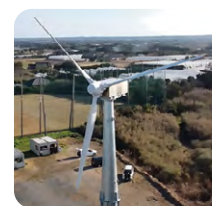
低圧風力発電機の 発電用増速機(ナセル)
