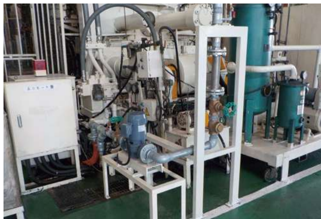
鋳造設備の冷却水循環装置
