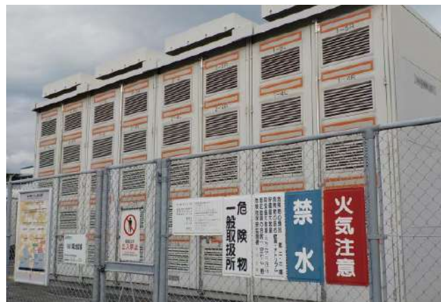
NaS電池設備
