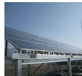
太陽光発電システム
