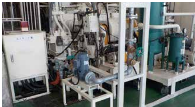
鋳造設備の冷却水循環装置
