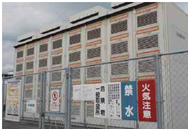
NAS電池設備
