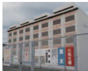
NAS電池設備
