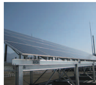
太陽光発電システム
