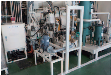
鋳造設備の冷却水循環装置
