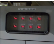
熱監視システム
