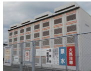
NAS電池設備
