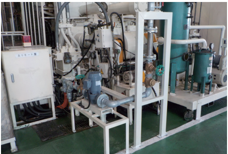
鋳造設備の冷却水循環装置
