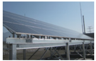
太陽光発電システム
