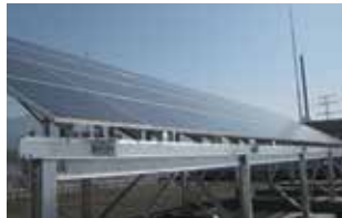
太陽光発電システム
