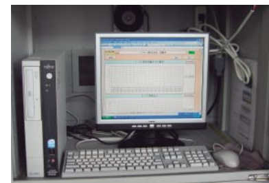
熱監視システム
