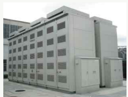
2,000KWの NAS電池設備
